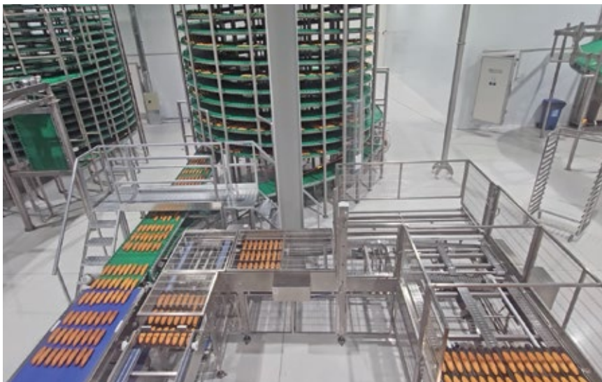
Prikaz izlaza iz peći i prelaska proizvoda na traku spirale za hlađenje na liniji za peciva
